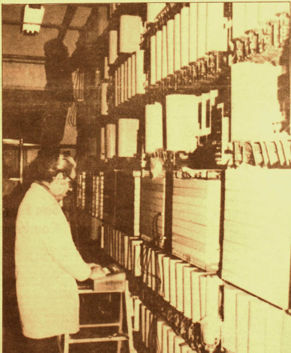
A partir de octubre de este año estaría en funciones la nueva planta telefónica de San Fernando, con lo cual se duplica el número de líneas y se adquieren otras facilidades, que son parte de la modernización del servicio desde esta ciudad de la Sexta Región al resto del país y al extranjero. En la escena se puede apreciar a los técnicos en el trabajo de montaje de los nuevos equipos.
